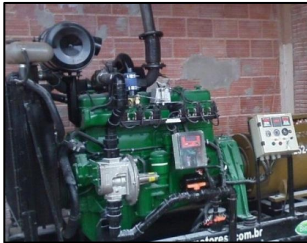
Figura 24 – Exemplo de gerador a biogás.
